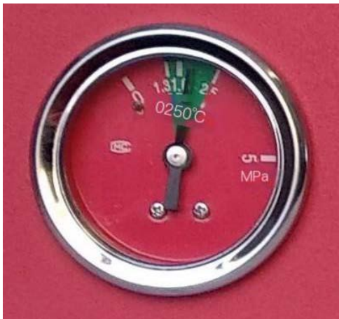
Рисунок 5-17 Манометр модуля системы пожаротушения
